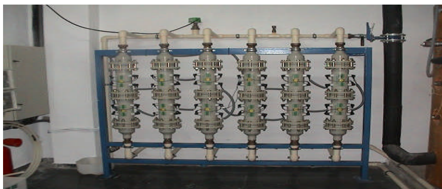
Sistema cobre-plata instalado en una red ACS.
