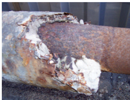
Calorifugado tubería de servicio de vapor de H 2 O
