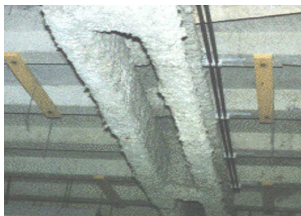
Amianto proyectado como ignífugante en viga metálica.
