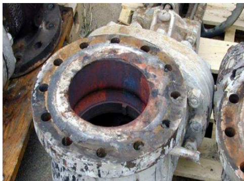
Juntas de estanqueidad de amianto
