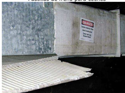
Placas de cartón-amianto en sistema de refrigeración
