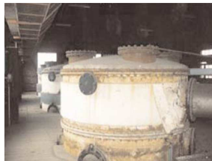
Calorifugado de amianto en reactor químico.
