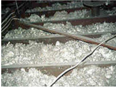
"Amianto perdido" aplicado como aislante en falso techo
